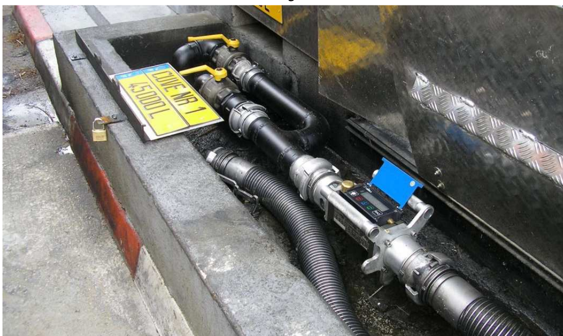
Inclinaison et rotation/axe longitudinal non conformes
